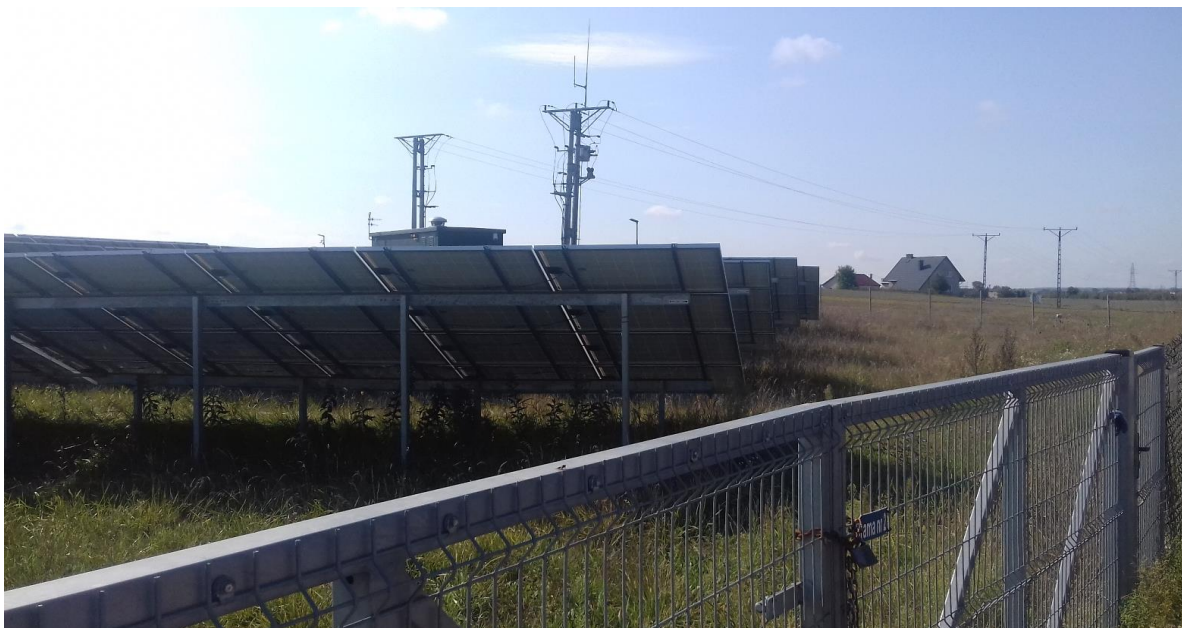
Zdjęcie. Przykładowe ogrodzenie wraz z systemem alarmowo – monitoringowym na farmie PV pod Lublinem (M. Szlaps)
