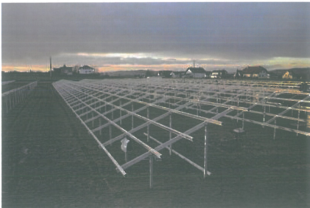
Rysunek 10: Szkielety przed montażem paneli, źródło: farma solarna NIENBURG 4 MW, Niemcy, Remor Solar.
